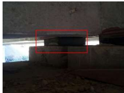
图 3-19: 雨亭分离式立交桥(上行) ZZ-R-1-0-1 支座: 大桩号面防尘罩缺失; 数量: 1 个。
