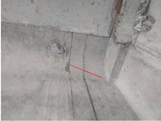
图 3-1：碑头高架桥（下行） 6—2T 梁：距 6 号墩 0m 处，左侧，翼板与腹板交接处斜向裂缝；数量：1 条，长度：0.6m，宽度：0.12mm。
