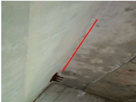
图 3-4: 东园高架桥(上行) 60-6T 梁: 距 59 号墩 0m 处, 左翼缘板纵向裂缝; 数量: 1 条, 长度: 0.6m, 宽度: 0.12mm。
