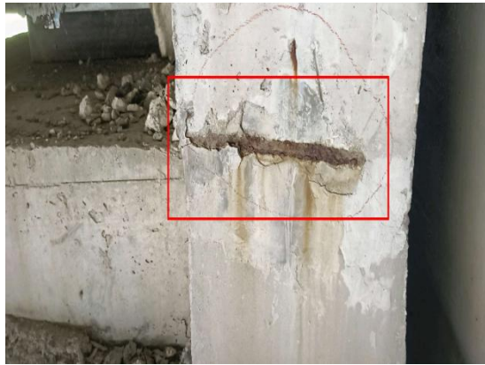
图 3-12: 新圩特大桥(上行) GL-23D 盖梁: 距左侧 0m 处, 大桩号面露筋; 数量: 1 处, 长度: 0.2m。
