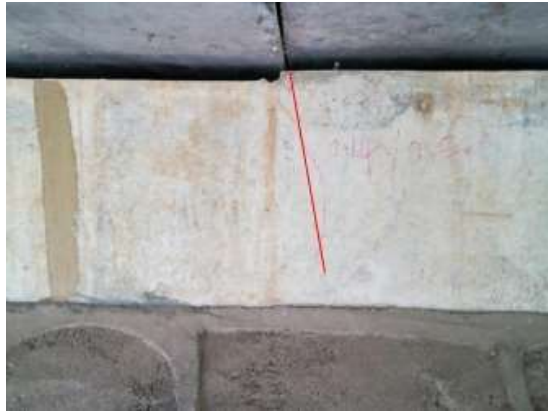
图 3-9: 八担中桥(下行) TS-4T 桥台: 前墙竖向裂缝; 数量: 1 条, 长度: 0.5m, 宽度: 0.13mm。
