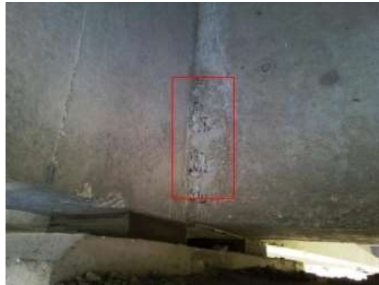
图 3-7: 油坑大桥(上行) 7-6-1H 上部一般构件: 大桩号面蜂窝、麻面; 数量: 1 处, 长度: 0.2m, 宽度: 0.5m。
