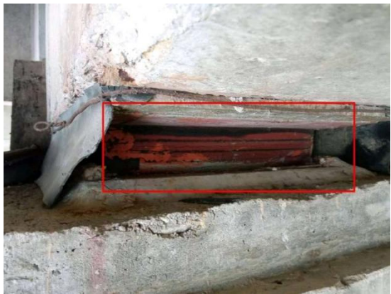
图 3-16: 东园高架桥(上行) ZZ-29-28-3 支座: 横向开裂; 数量: 6 条, 长度: 0.15m, 宽度: 1mm。
