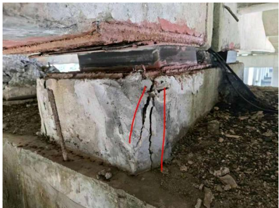
图 3-18: 旧镇特大桥(上行) ZZ-26-25-4 支座: 左侧垫石开裂破损; 数量: 2 处, 长度: 0.6m, 宽度: 0.04m。
