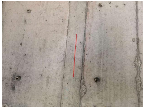
图 3-3: 海澄主线分岔老路 B 线 1 号桥 29-1-2H 横隔板: 大桩号面竖向裂缝; 数量: 1 条, 长度: 1m, 宽度: 0.12mm。
