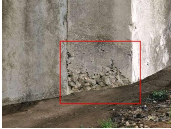
图 3-14: 东园高架桥(上行) GL-28D 盖梁: 右侧蜂窝、麻面; 数量: 1 处, 长度: 0.2m, 宽度: 0.2m。
