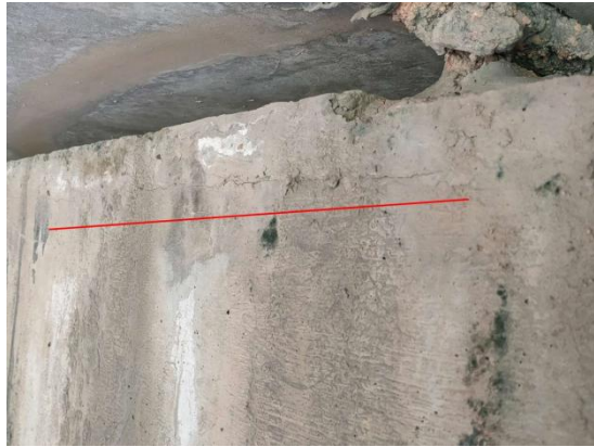
图 3-10: 顶厝中桥(上行) TM-1T 桥台: 台帽横向裂缝; 数量: 1 条, 长度: 1m, 宽度: 0.12mm。
