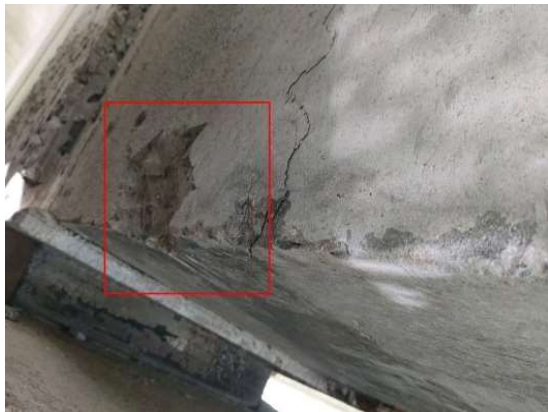
图 3-6: 东园互通 D 匝道桥 4-1T 梁: 距 3 号墩 0.5m 处, 马蹄右侧面剥落、掉角; 数量: 1 处, 长度: 0.2m, 宽度: 0.2m。
