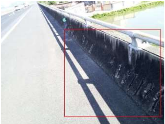
图 3-20 碑头高架桥(下行) HL-L-1 栏杆、护栏: 左侧, 护栏露筋; 数量: 10 处, 长度: 0.5m。
