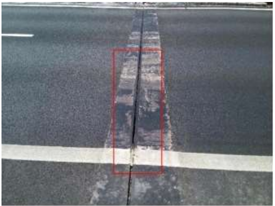
图 3-23 白衣 2#分离式立交桥(上行) 2f 伸缩缝: 伸缩缝型钢卡死; 数量: 1 处。
