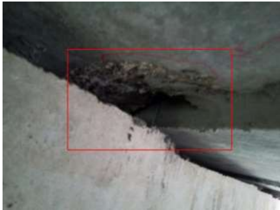
图 3-8: 田厝中桥(下行) 4-6 空心板: 距 3 号墩 0m 处, 板底剥落、掉角; 数量: 1 处, 长度: 0.1m, 宽度: 0.3m。
