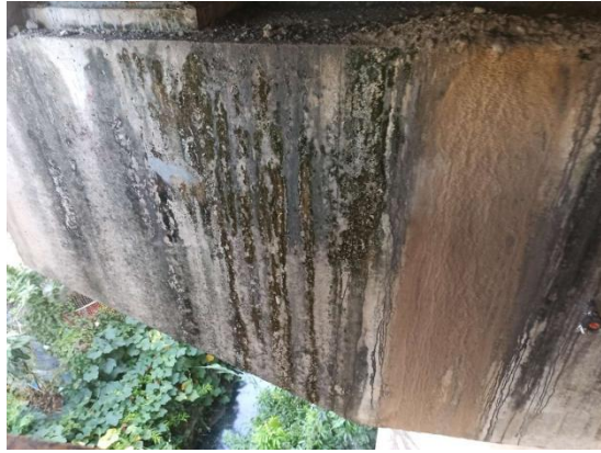
图 3-13: 旧镇特大桥(上行) GL-7D 盖梁: 受水侵蚀。
