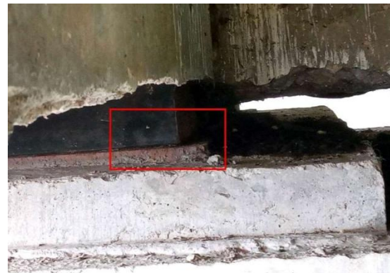
图 3-15: 东园高架桥(上行) ZZ-44-43-1 支座: 脱空; 数量: 1 个, 百分比: 10%。
