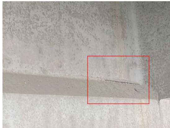
图 3-5: 碑头高架桥(下行) 4-1T 梁: 距 4 号墩 5m 处, 右腹板露筋; 数量: 1 处, 长度: 0.3m。
