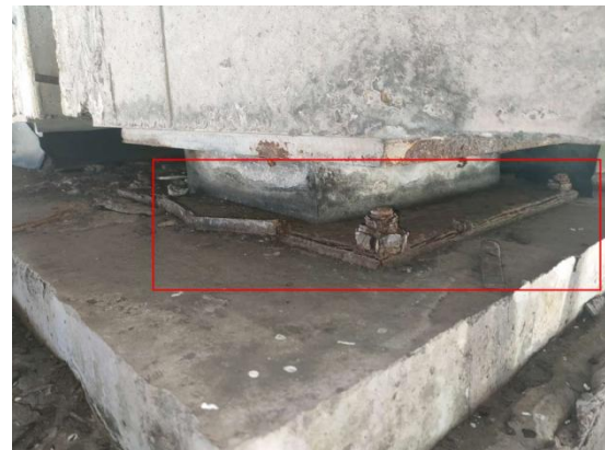
图 3-17: 东园高架桥(上行) ZZ-54-53-5 支座: 钢板锈蚀; 数量: 1 个。
