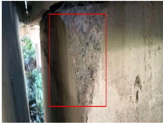
图 3-11: 新圩特大桥(上行) GL-22D 盖梁: 左侧剥落; 数量: 1 处, 长度: 0.3m, 宽度: 0.2m。
